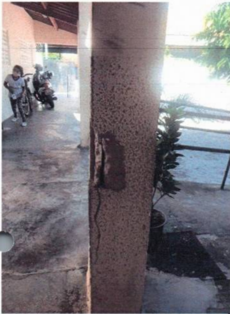
Figura 2: Situação atual do pilar da escola
