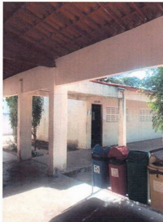
Figura 6: Pilares e pintura devem ser reparados
