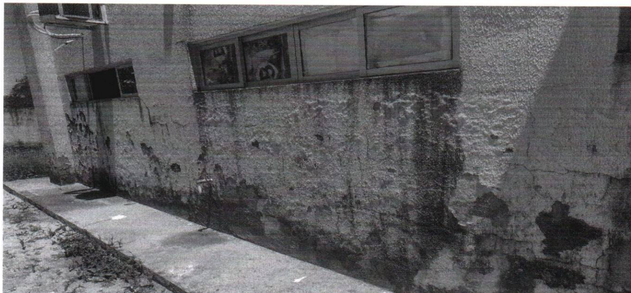
Reboco externo comprometido
